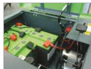
ALOJAMIENTO DE BATERÍAS (1280 E)
